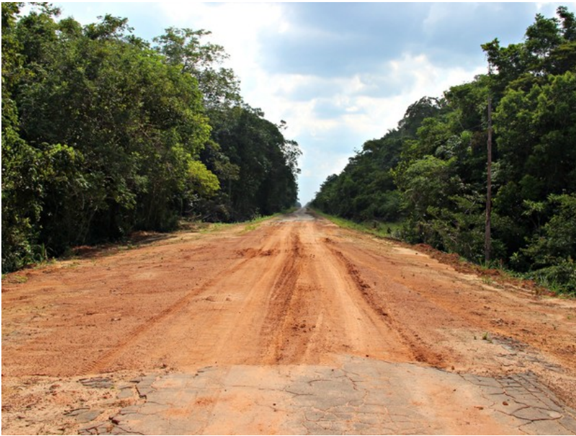
Trecho central da rodovia tem apenas pedaços
